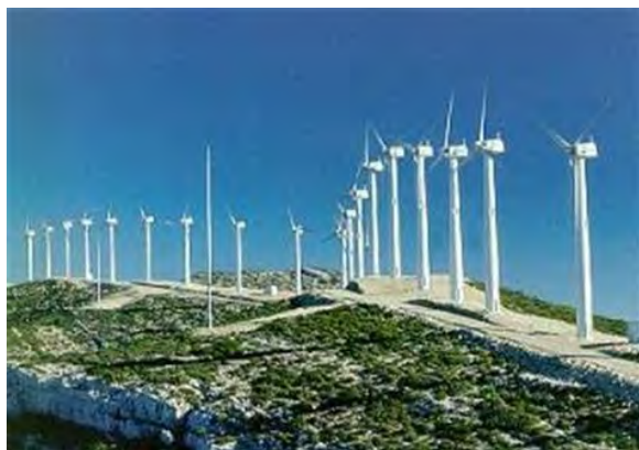
FIGURA 5. Parc eòlic del Baix Ebre, de 4 MW amb 27 aerogeneradors.
